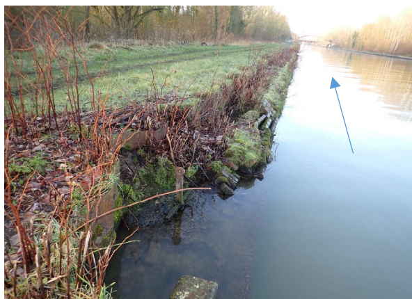
Rideau de palplanches - RG- ancien perré en briques à l'état de ruine - PK6300
