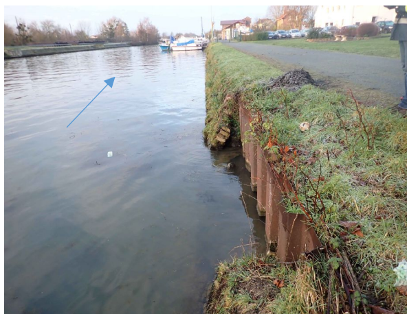
Perré en briques et rideau de palplanches ponctuel (remplacement d'un effondrement local ?) - PK180
